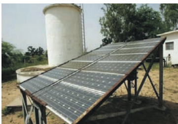
Giovanni De Paoli, responsabile per l'Enea del progetto Freddas, e i pannelli fotovoltaici montati nel Nord del Senegal
